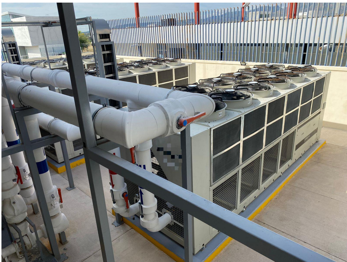
Figura 3. Chiller de 204 TR, Foto propia tomada en un Centro de Datos de región bajo.
